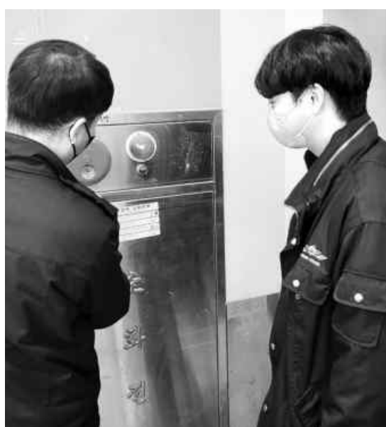
담양소방서(서장 박상래)는 최근 관내 다문화가정 구성원과 외국인을 고려한 옥내소화전 한글·외국어 동시 표기 사용설명 스티커를 홍보했다. <담양소방서 제공>
