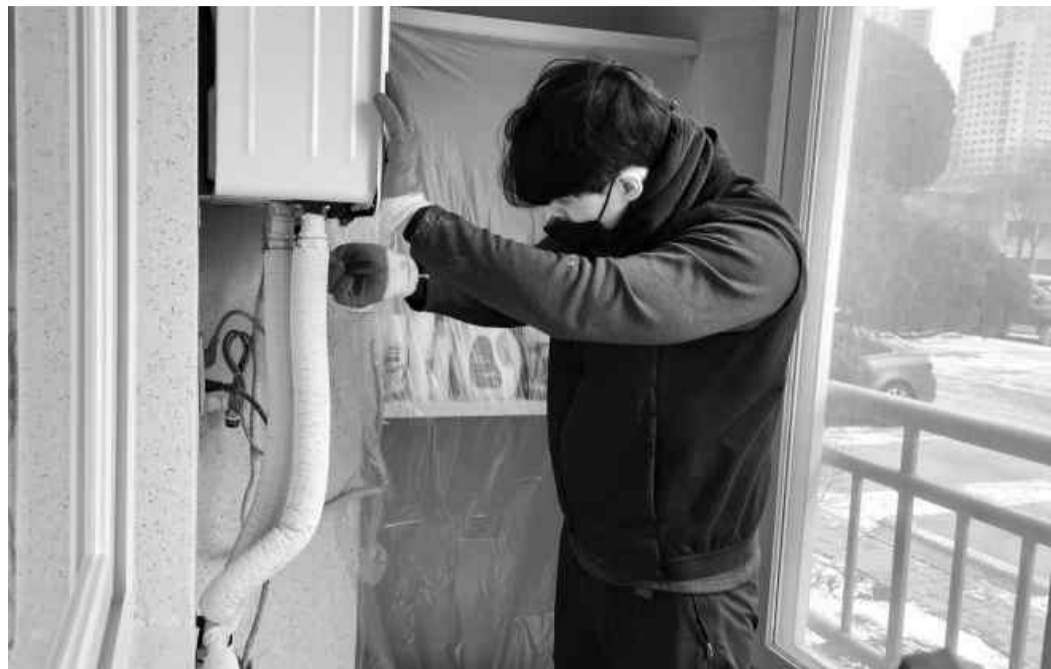
강한 한파로 광주지역에서 동파사고가 이어지는 가운데, 수도관 정비업체 직원이 26일 광주시 북구 각 화동 한 아파트에서 동파된 수도관을 수리하고 있다. /민천기 기자 hyunki@kwangju.co.kr
