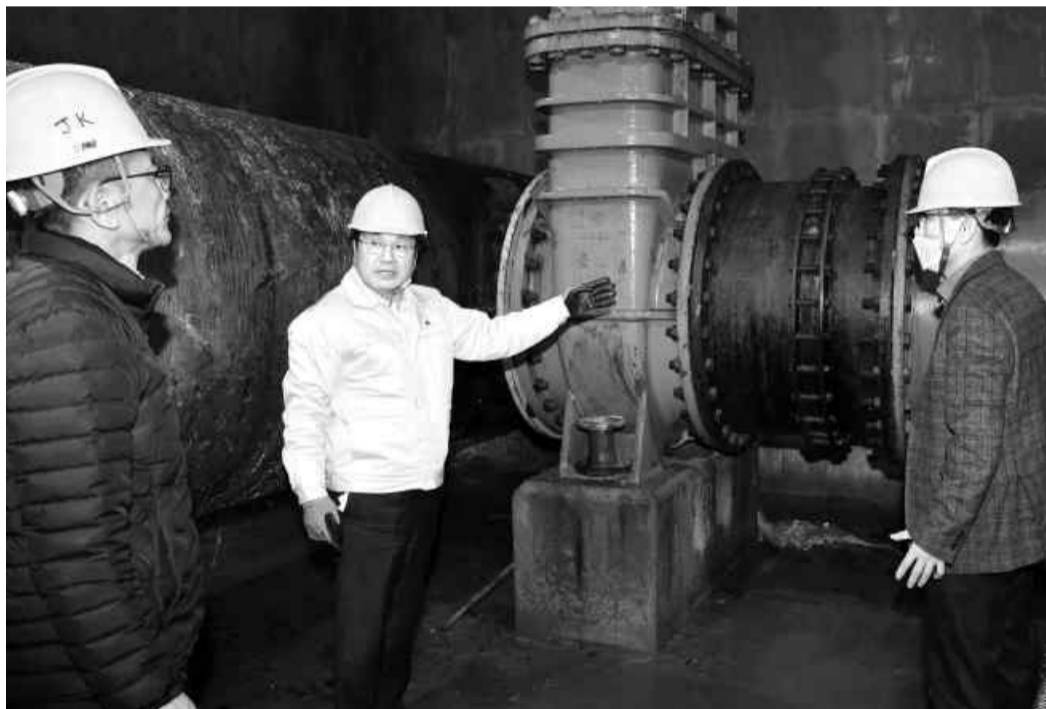
강기정 광주시장이 14일 오후 동구 용연정수장 지하에 위치한 정수 유출밸브실에서 바이패스 배관과 밸브 상태를 점검하고, 철저한 안전관리를 당부하고 있다.
