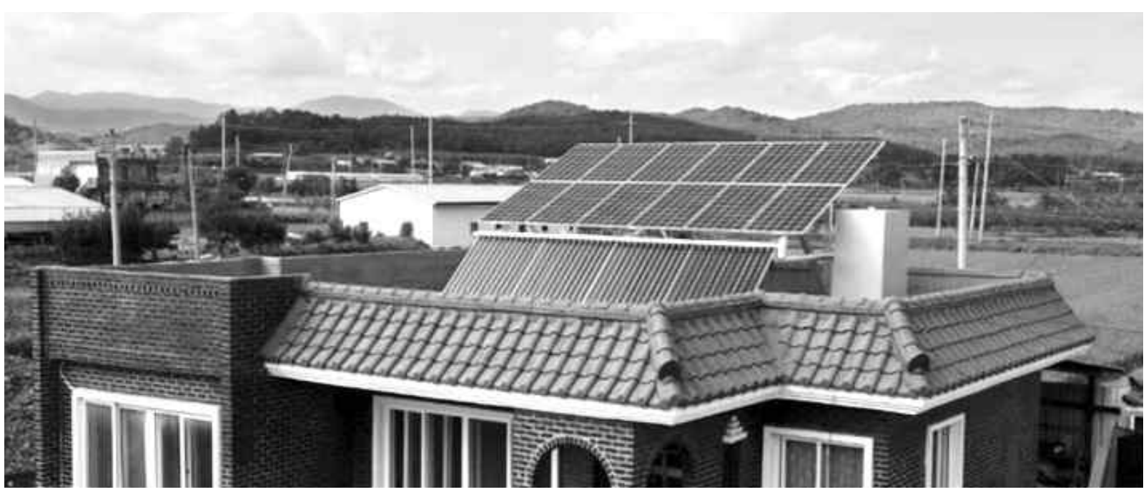
영암군은 올해 말까지 11개 읍·면 1215개소에 신재생에너지 발전설비를 설치할 계획이다. 영암 한 주택에 설치된 태양광 설비.
