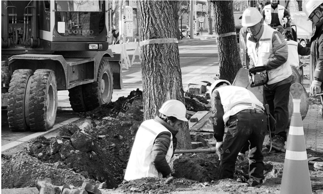
장성군이 장성읍 성산마을 도로변 0.5km 구간에 식재된 은행나무 107그루를 장성천 일원으로 이식을 시작했다. <장성군 제공>
