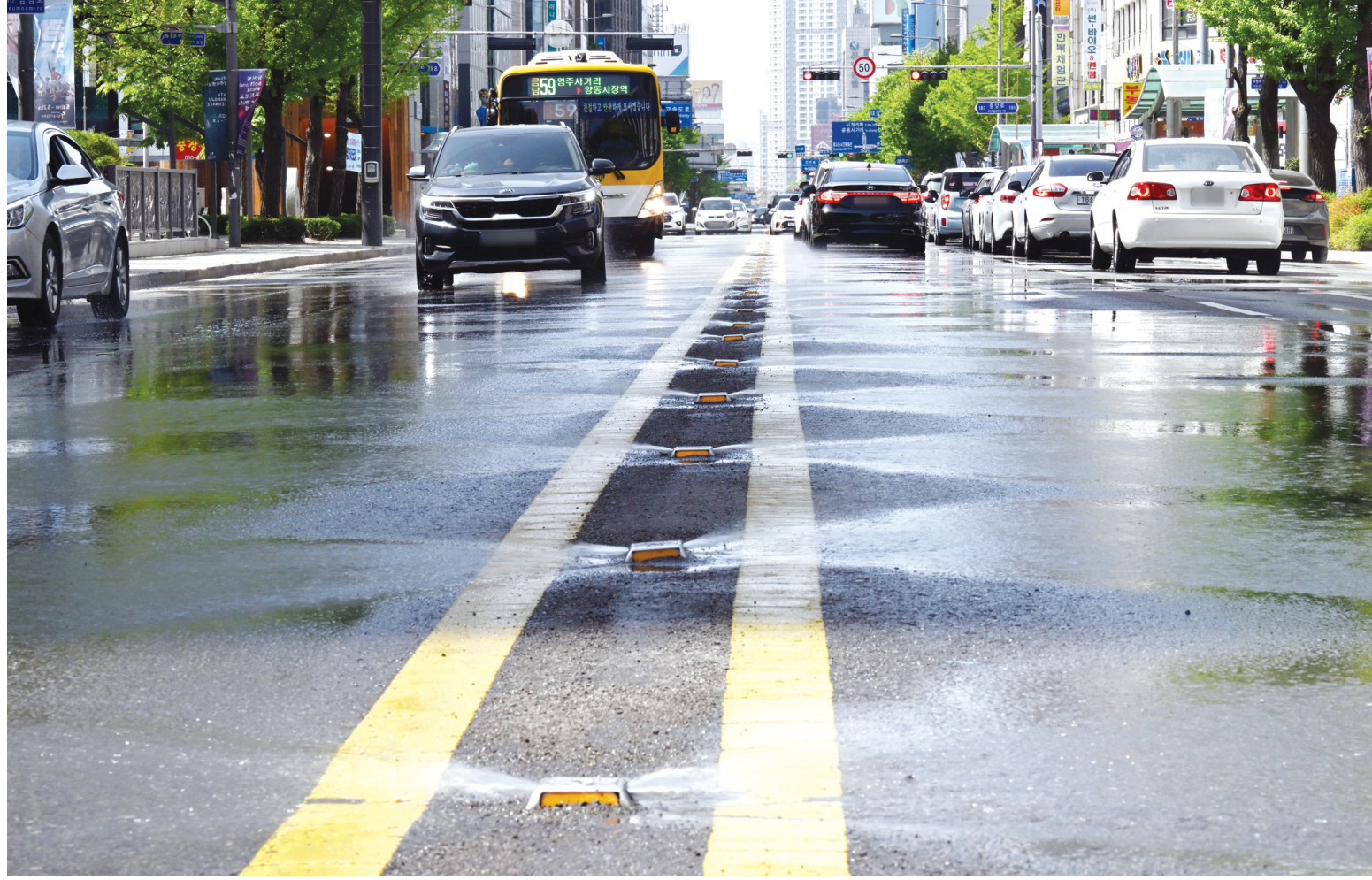
광주 금남로 '쿨링로드' 가동 2일 광주시 동구 금남로 중앙선에 설치한 '쿨링로드'가 작동하고 있다. 쿨링로드는 불가열엔 미세먼지 저감 장치로, 여름 폭염엔 더위를 식혀주는 역할을 한다. /나영주기자mjna@kwangju.co.kr
