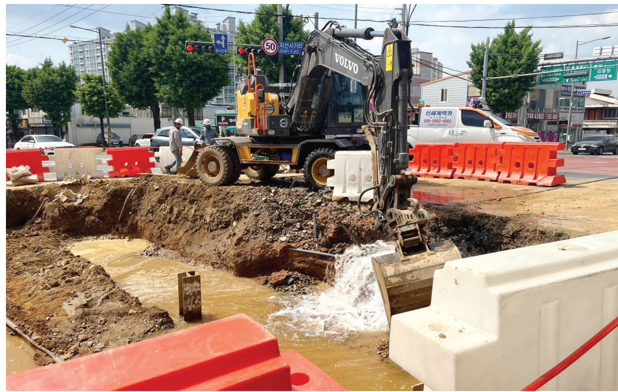
지하철 공사중 상수도관 파열
