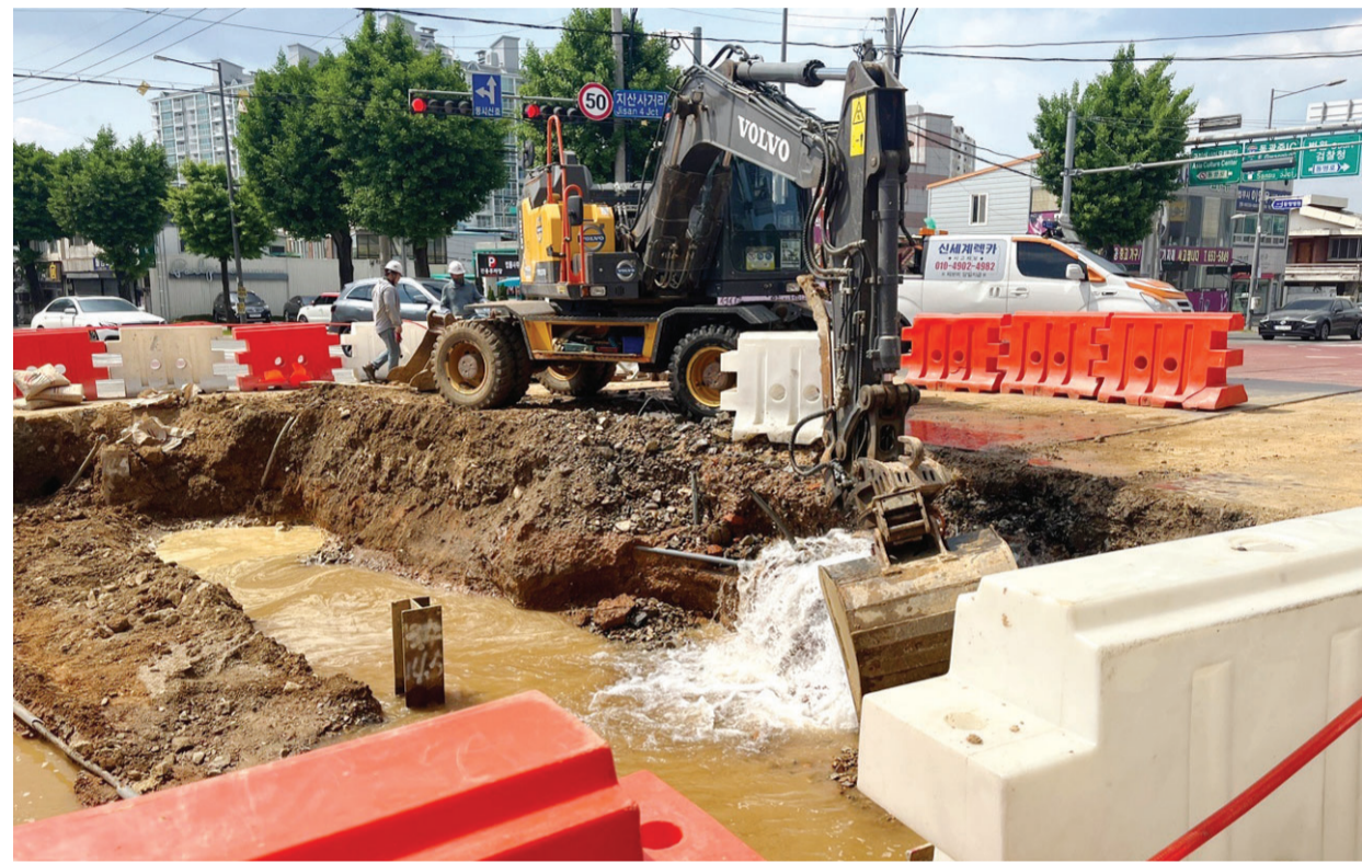
지하철 공사중 상수도관 파열
