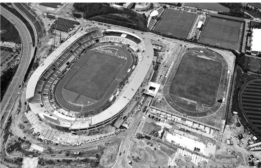
10월 전국체전, 11월 전국장애인체전 개·폐회식과 주요 종목 경기가 열린 목포종합경기장 건립이 악천후로 완공 시기를 다음 달로 미루게 됐다. 지난 19일 촬영한 경기장 건설 현장. <목포시 제공>
