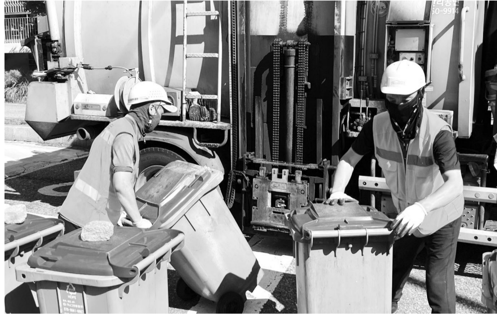
환경미화원이 3일 오전 광주시 광산구 월계동의 아파트에서 음식물쓰레기를 처리하고 있다.(왼쪽) 같은날 오후 장성군 남면에선 배선노동자들이 변압기 교체 작업을 하고 있다.
