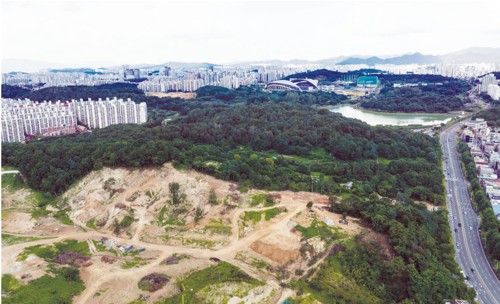
6일 오후 광주시 서구 풍암동 중앙1지구 민간공원특례사업지에서 공원 정비 등을 위한 도로개설 공사 준비가 한창이다. 사업자측은 오는 2027년까지 2조 1000억원을 투입, 87개의 테마숲을 비롯한 2772세대 규모의 '롯데캐슬 시그니처' 아파트를 신축한다. /최한배 기자 choi@kwangju.co.kr
