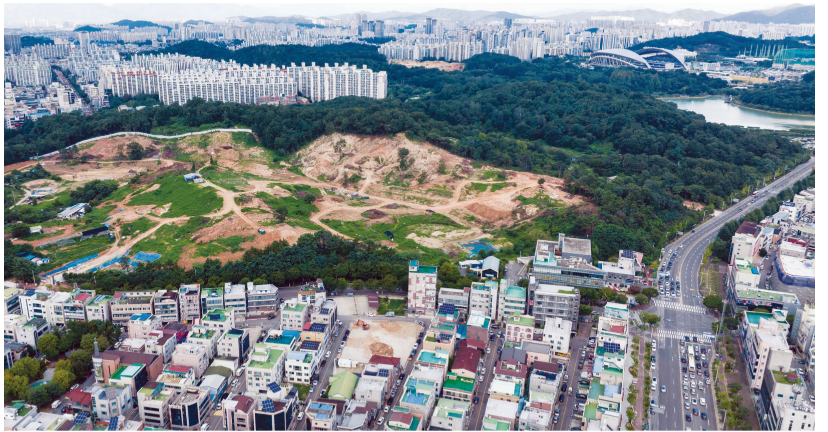
9일 중앙공원 1지구 민간사업자인 빛고을중앙공원개발(주)이 광주시 서구 풍암동 사업지에서 공원정비 공사 등을 하고 있다. 사업지는 오는 2027년까지 2조 1000억원을 투입해 8개 기능을 갖춘 테마숲과 2772세대 규모의 아파트를 짓는다. /최현배 기자 choi@kwangju.co.kr
