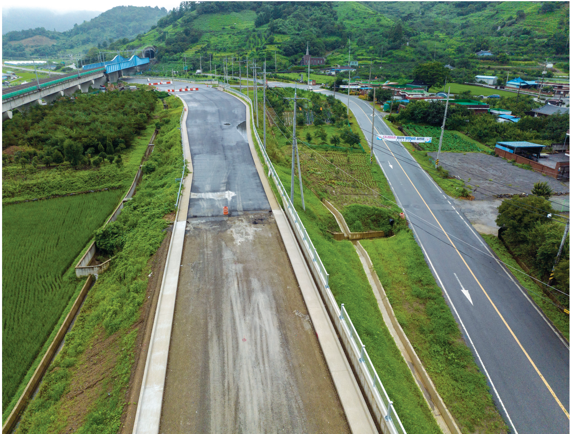
국가지원지방도 제58호선은 나주 금천면과 부산 강서구를 잇는다. 여러 도로와 중복되다가 광양부터 분명하게 드러나는데, 컨테이너 부두 배후부지, 동광양 나들목, 광양제철소, 광양항 등과의 연계를 돕는 중요한 도로다. 사진은 현재 공사가 진행중인 구간.
