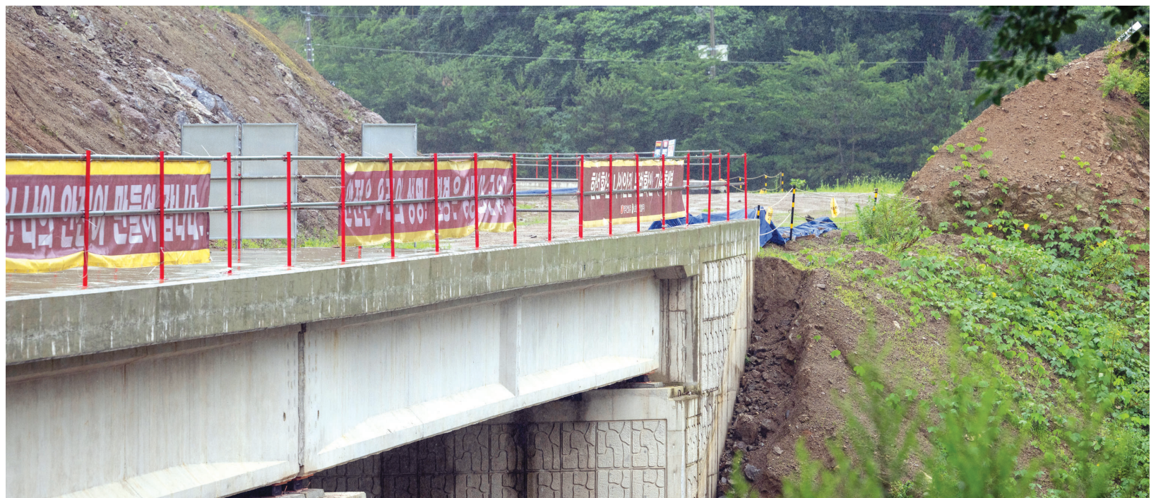
순천 낙안~상사 구간은 상사호와 이사천 등을 끼고 금천산(667.9m), 오봉산(597.4m) 등 500~600m 이상의 산봉우리 주변을 지나며 경사가 급하고 선형이 구불구불해 산사태의 가능성이 높다. 순천의 중요 관광자원인 낙안읍성, 상사호 등이 있어 차량 통행량도 상당하다.
