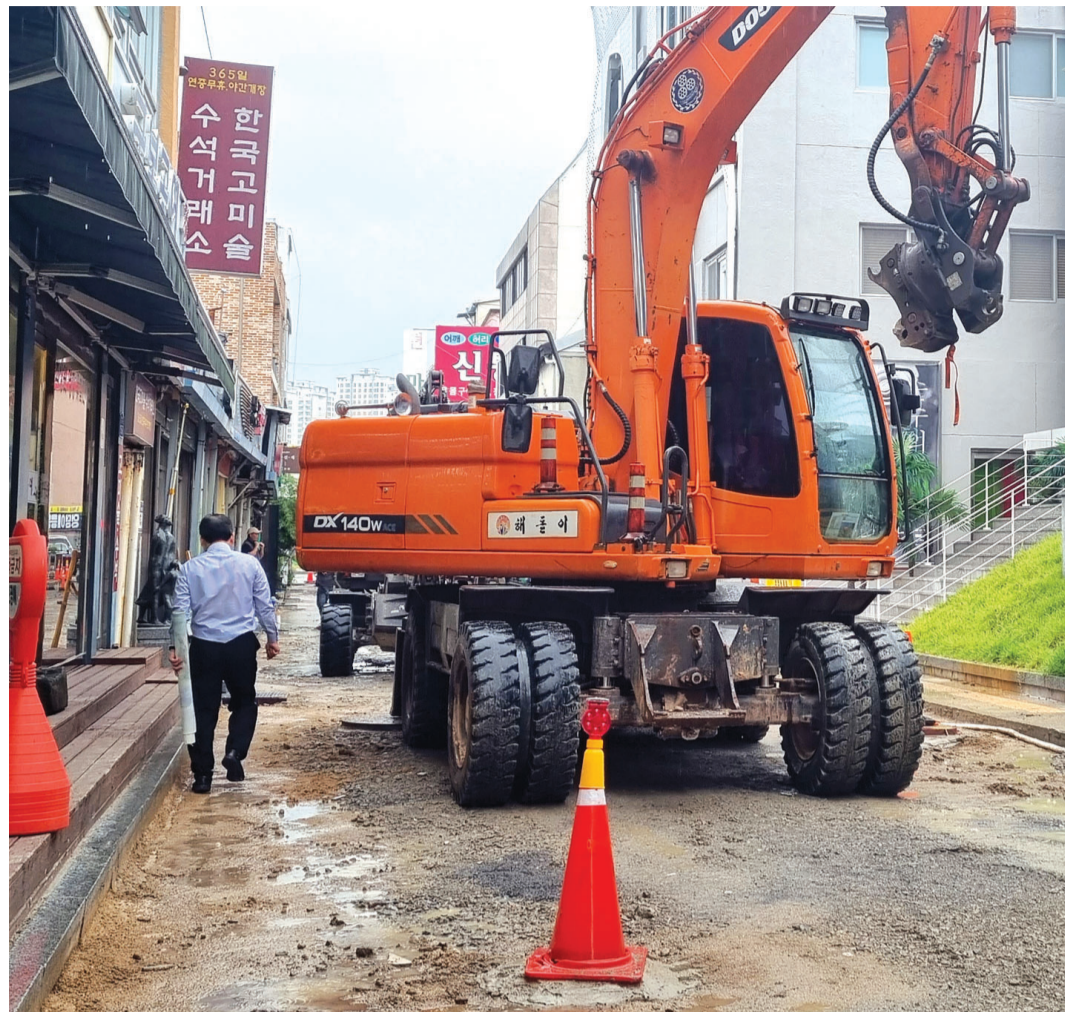
14일 광주시 동구 공동 예술의거리 보·차도 공사 현장에서 한 시민이 중장비 옆을 아슬아슬하게 걷고 있다. /나명주 기자 mjna@kwangju.co.kr
