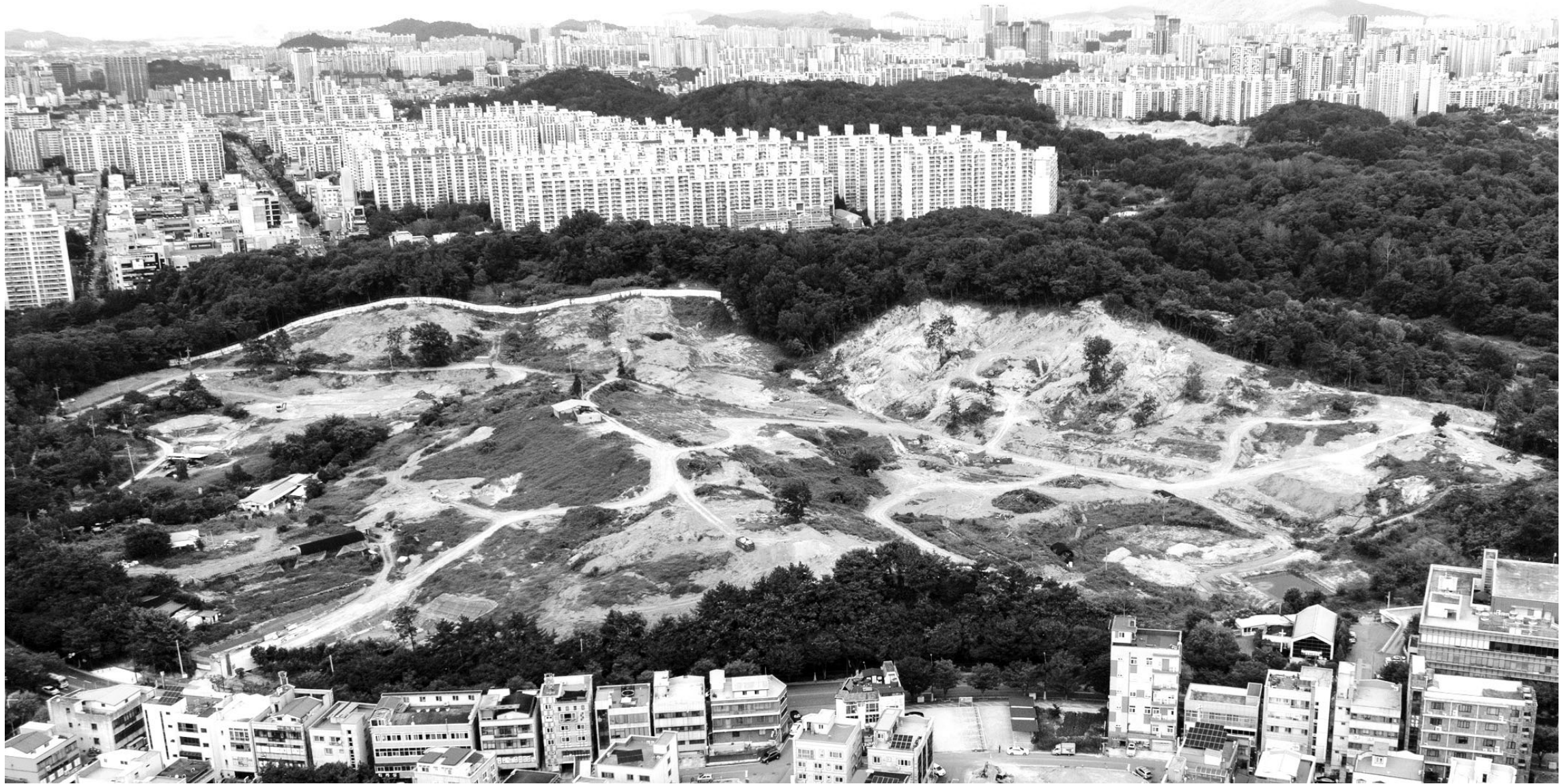
중앙공원 1지구 민간사업자인 빛고을중앙공원개발(주)이 광주시 서구 중앙동 사업지에서 공원정비 공사 등을 하고 있다. 사업자는 오는 2027년까지 2조1000억원을 투입해 8개 기능을 갖춘 공원과 2772세대 규모의 아파트를 짓는다. /최현배 기자 choi@kwangju.co.kr
