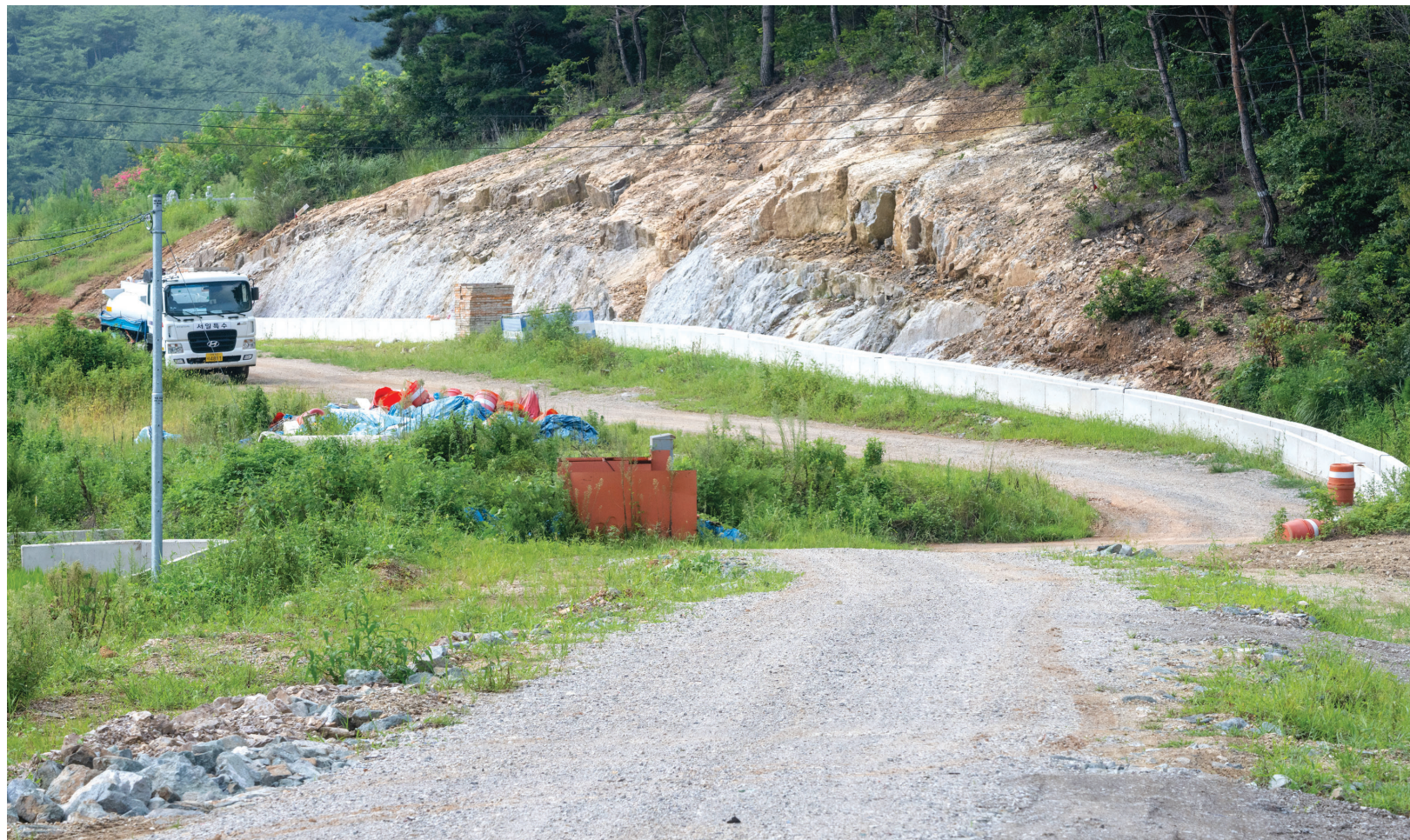
277억 원이 투입되는 이번 공사는 오는 2024년 11월 마무리될 예정이다. 사진은 고흥 과역면 연동리 공사 현장.
