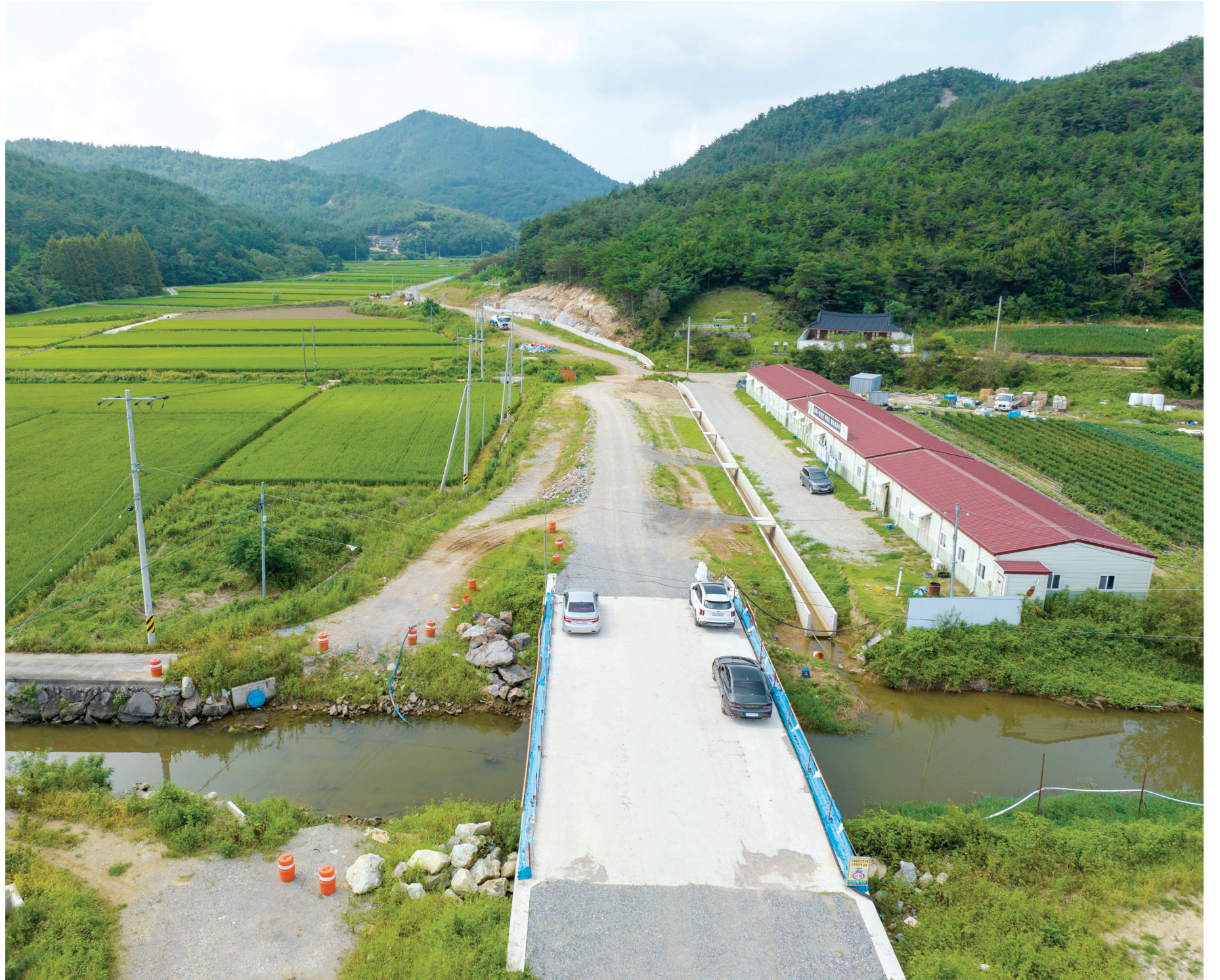
전남도는 고흥과 여수를 잇는 백리섬섬길, 여수~남해 해저터널 등의 사업을 통해 남해안을 세계적인 관광지로 조성할 방침이다. 관광객들이 이들 핵심 자원에 쉽게 접근할 수 있게 하기 위한 기반시설 공사도 추진중이다. 그 대표적인 것이 지방도 제843호선 고흥 과역~남양 구간이다.
