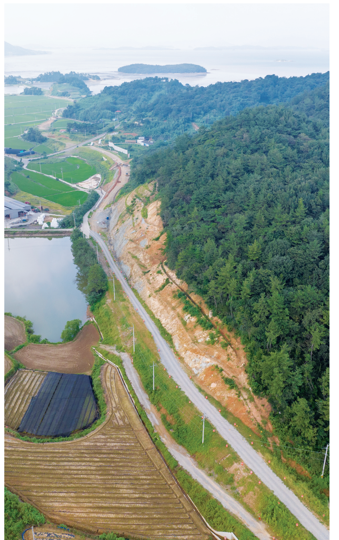
좁고 굴곡도 심한 지방도 제843호선을 곧게 펴고 버스 등 대형 차량들이 지나갈 수 있게 폭을 넓히는 것이 이번 사업의 골자다. 사진은 고흥 과역면 호덕리에서 드론이 촬영한 공사 현장.
