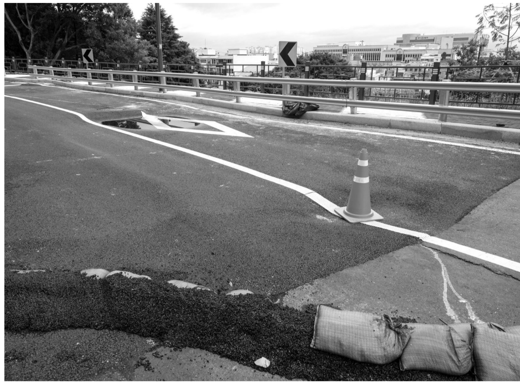
지난 7월 광주시 동구 지산동과 조선대 사범대를 잇는 도로가 지반 침하 및 침수 피해를 입어 차량 출입이 통제되고 있다. /김진수 기자 jeans@kwangju.co.kr
