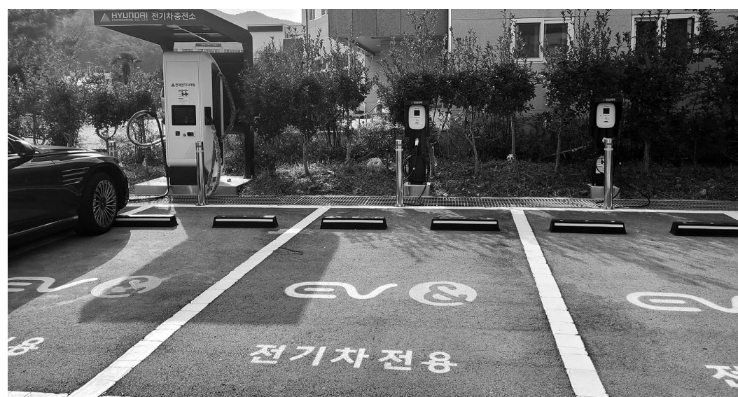
고흥 공공시설 주차장에 설치된 전기자동차 충전기. <고흥군 제공>
