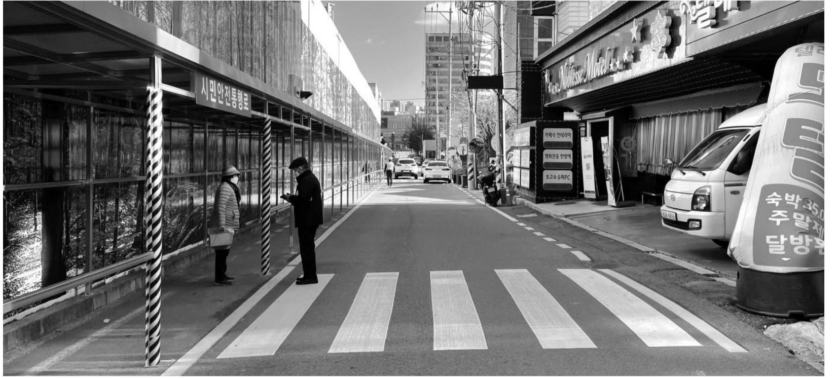
30일 광주시 서구 화정동 아이파크 아파트 철거 및 재시공 현장 인근에 설치된 안전보행로와 횡단보도.
