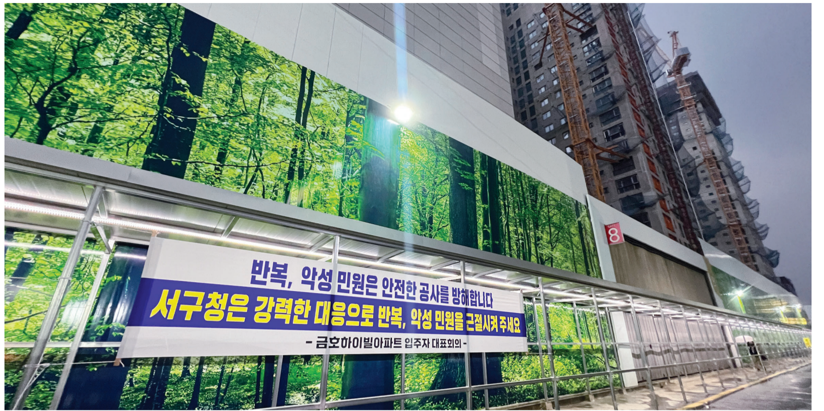
6일 광주시 서구 화정동 아이파크 아파트 철거 현장 인근 보행로에 '악성 민원을 근절시켜달라'는 금호하이빌아파트 입주자대표회의의 명의로 현수막이 걸려 있다. /김진수 기자 jeans@kwangju.co.kr
