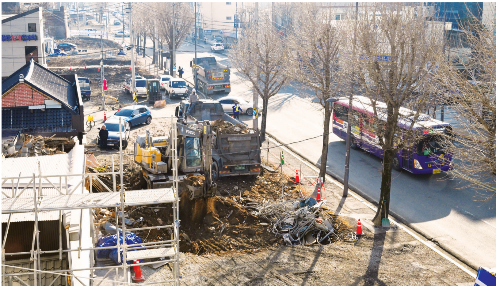
동구청~조선대 정문 도로 확장 중 27일 광주시 동구청 일대에서 도로 확장 공사가 진행되고 있다. 광주시는 내년 1월까지 도로 인근 노후 건축물 177개동을 철거한 뒤, 동구가 동구청 별관 건물 일부를 철거하는 작업을 마치는대로 기존 왕복 4차로를 가변형 왕복 5차로로 확장하는 공사를 실시할 방침이다. /나명주 기자 mjna@kwangju.co.kr
