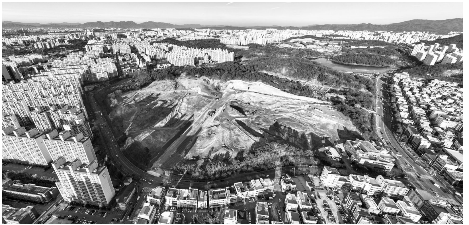
광주 최대 규모를 자랑하는 서구 풍암동 '중앙1지구 민간공원특례 사업지'에서 기초 공사가 한창이다. 사업자측은 8개의 테마숲을 갖춘 명품 공원과 함께 2772세대 규모의 명품 롯데캐슬 시그니처아파트를 신속할 예정이다. /김진수 기자 jeans@kwangju.co.kr
