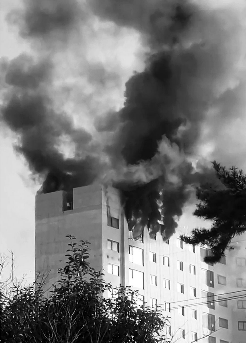
신축 아파트 공사 현장서 불 광주시 남구 봉선동의 한 신축 중인 아파트 16층에서 지난26일 오전 8시께 불이 났다. 불로 인한 인명피해는 발생하지 않았으며 오전 9시께 진화됐다. <독자 제공>
