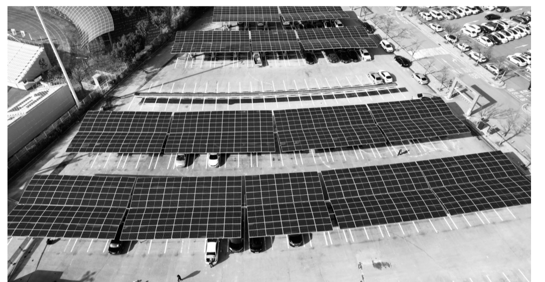
광주도시공사가 광주 월드컵경기장 주차장 부지 내에 설치한 499kW 규모 태양광 발전소 전경.
