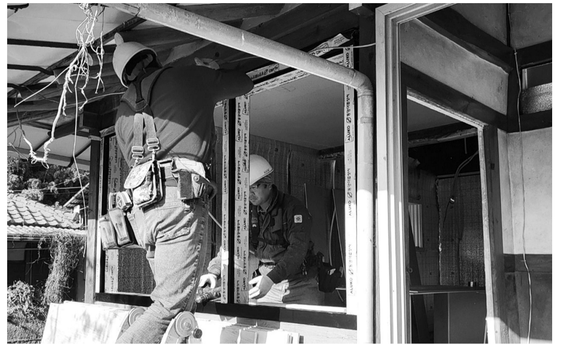
나주시가 올해부터 2029년까지 해마다 6개 마을을 '귀농·귀촌 선도마을'로 선정해 기반시설 조성, 빈집 정비 등을 펼친다. 귀농·귀촌인의 임시 보금자리 마련을 위해 빈집을 정비하는 모습. <나주시 제공>
