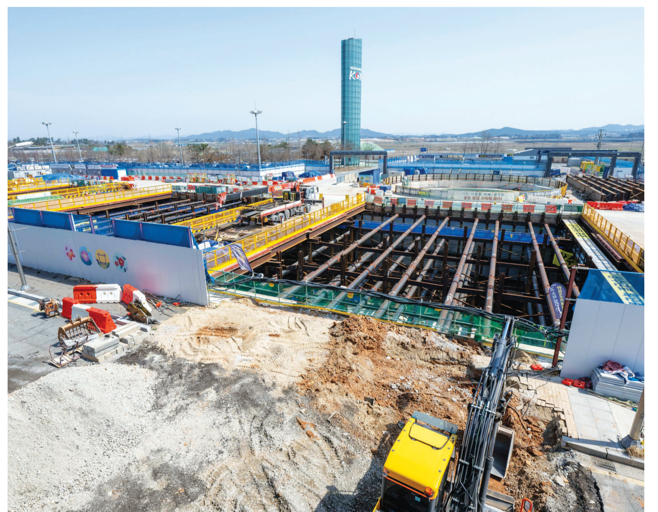
무안국제공항 주차장 지하에 들어설 예정인 무안국제공항역 공사 현장. 비수도권에서는 최초로 국제공항을 경유하는 고속철도역이다.
