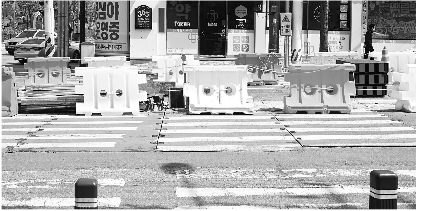
최근 광주시 북구 풍향동의 광주도시철도 2호선 1단계 6공구 공사 현장에서 횡단보도가 공사 적치물로 인해 가로막혀 있다. /니명주 기자 mjna@kwangju.co.kr
