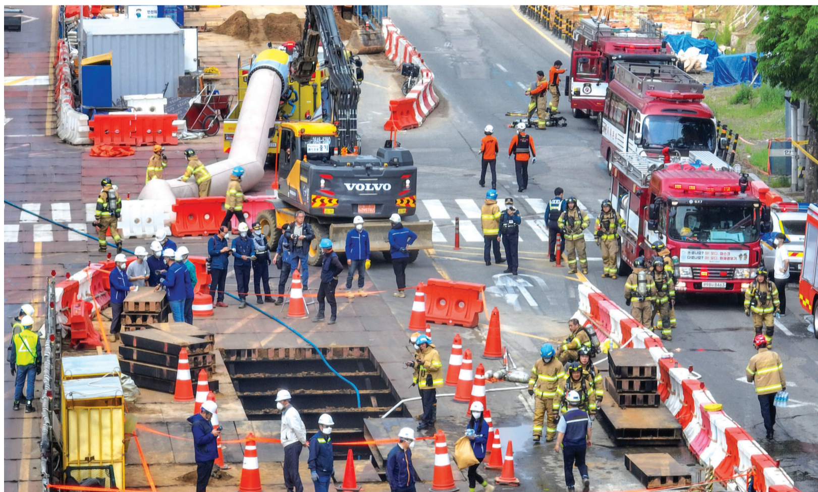
지하철공사장 화재 2일 오전 8시 40분께 광주시 남구 봉선동 남광주농협 인근 지하철 공사장에서 화재가 발생해 긴급 출동한 소방에 의해 1시간여만에 진화됐다. 소방대원들이 공사장 주변에서 사고 수습을 하고 있다. /김진수 기자 jeans@kwangju.co.kr
