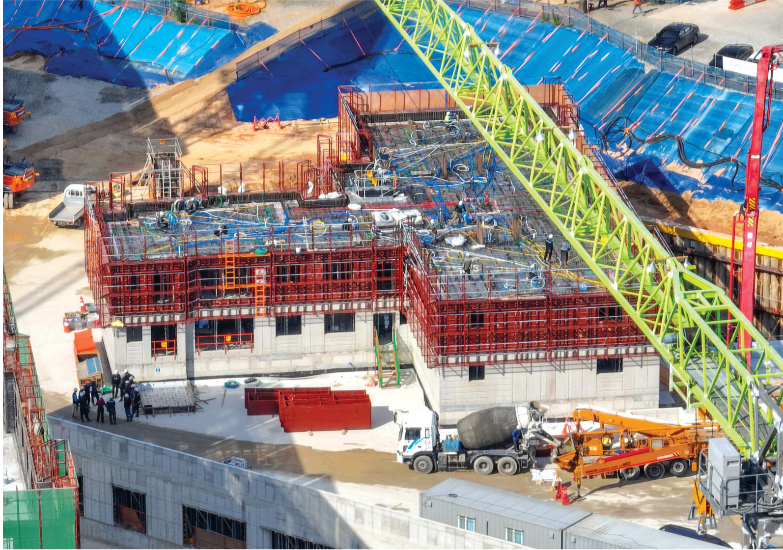
26일 광주의 한 아파트 신축공사 현장에서 지상층 공사가 한창이다. 최근 지역에서 자금난을 버티지 못하는 중소건설기업이 늘어나고 있다.
