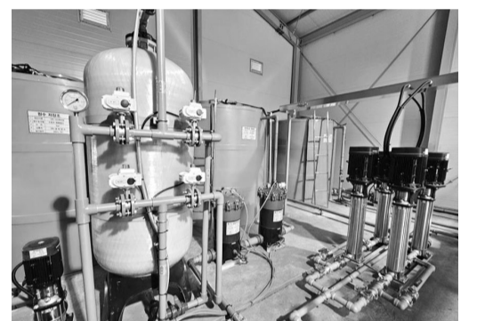
완도군이 설치해 가동 중인 해수 담수화 시설.
