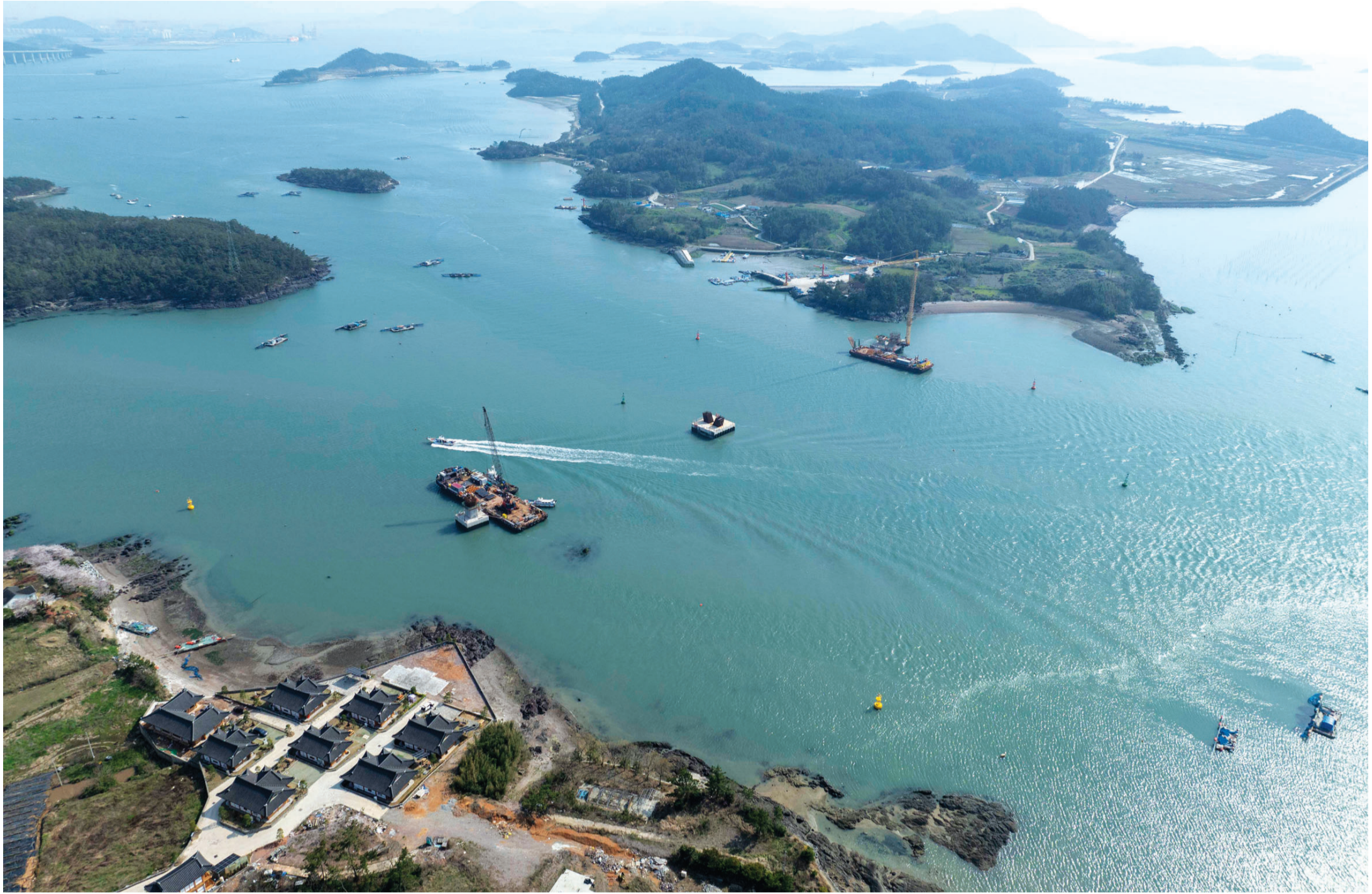
신안 압해도에서 바라본 2공구 목포 울도·달리도~신안 압해 간 7.54km 공사 현장. 해상교량 1.68km짜리 2개가 들어설 예정이다.
