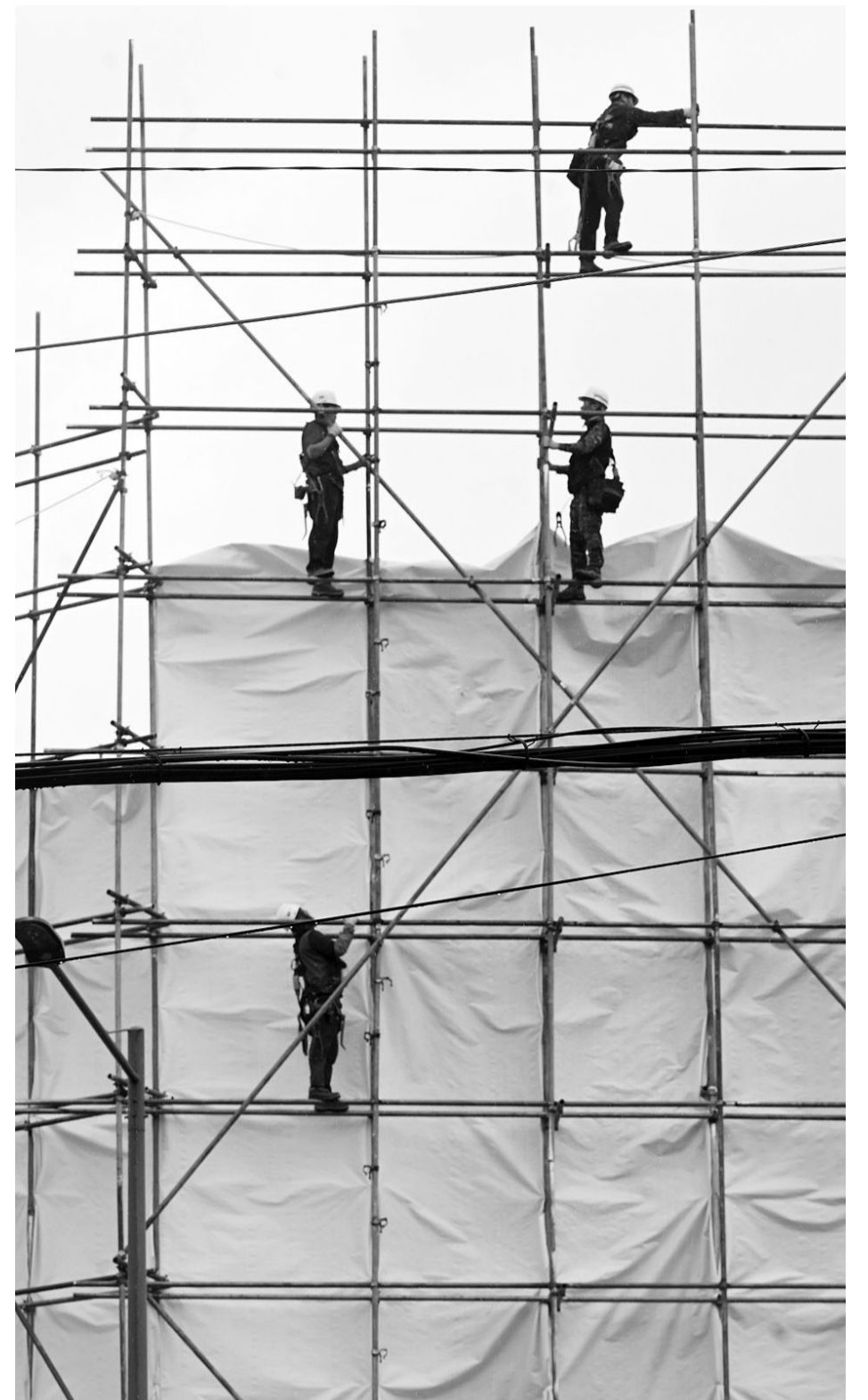
북구청 신관 공사 현장 18일 광주시 북구청 신관 공사현장에서 관계자들이 가림막 작업을 하고 있다. 신관 완공은 2026년 1월로 예정돼 있다. /나명주기자mjna@kwangju.co.kr
