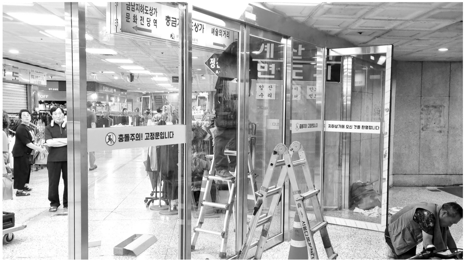
광주 지역에 폭염이 계속되는 가운데 25일 오후 광주시 동구 충금지하도상가에 냉·난방 에너지 사용 효율을 높이기 위한 중문이 설치되고 있다. /나명주 기자 mjna@kwangju.co.kr
