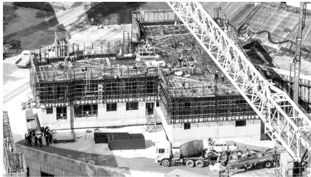
광주의 한 아파트 단지 건설현장. 건설경기 불황으로 공사수주액이 감소하면서 폐업하는 건설회사가 증가하고 있다. <광주일보 DB>
