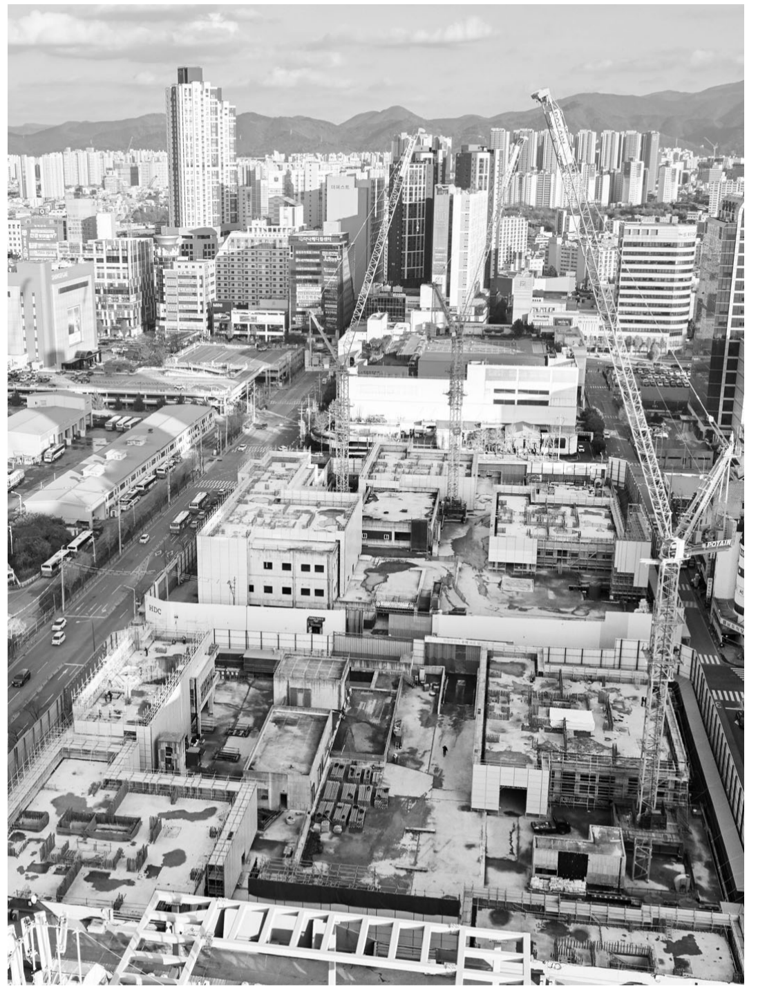
17일 광주 서구 화정동 아이파크 아파트 철거 공사가 마무리됐다. 철거-재시공 현장에 철거 대상에서 제외된 1~3층 상가부 건축물이 남아 있다. /김진수 기자 jeans@kwangju.co.kr
