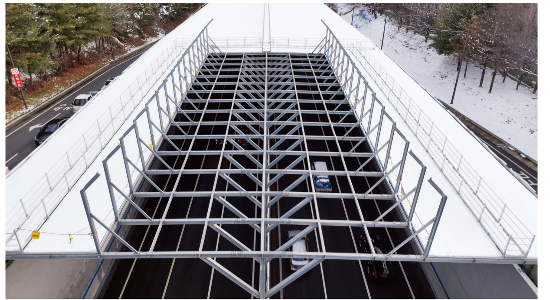
광주시가 제2순환도로(신창·수완지구) 소음 민원 해결을 위해 설치한 방음터널 캐노피(덮개) 중 일부가 뚫려 있어 인근 주민들이 소음 피해를 호소하고 있다. 제2순환도로(신창·수완지구) 방음터널 캐노피 개방 구간. /김진수 기자 jeans@kwangju.co.kr
