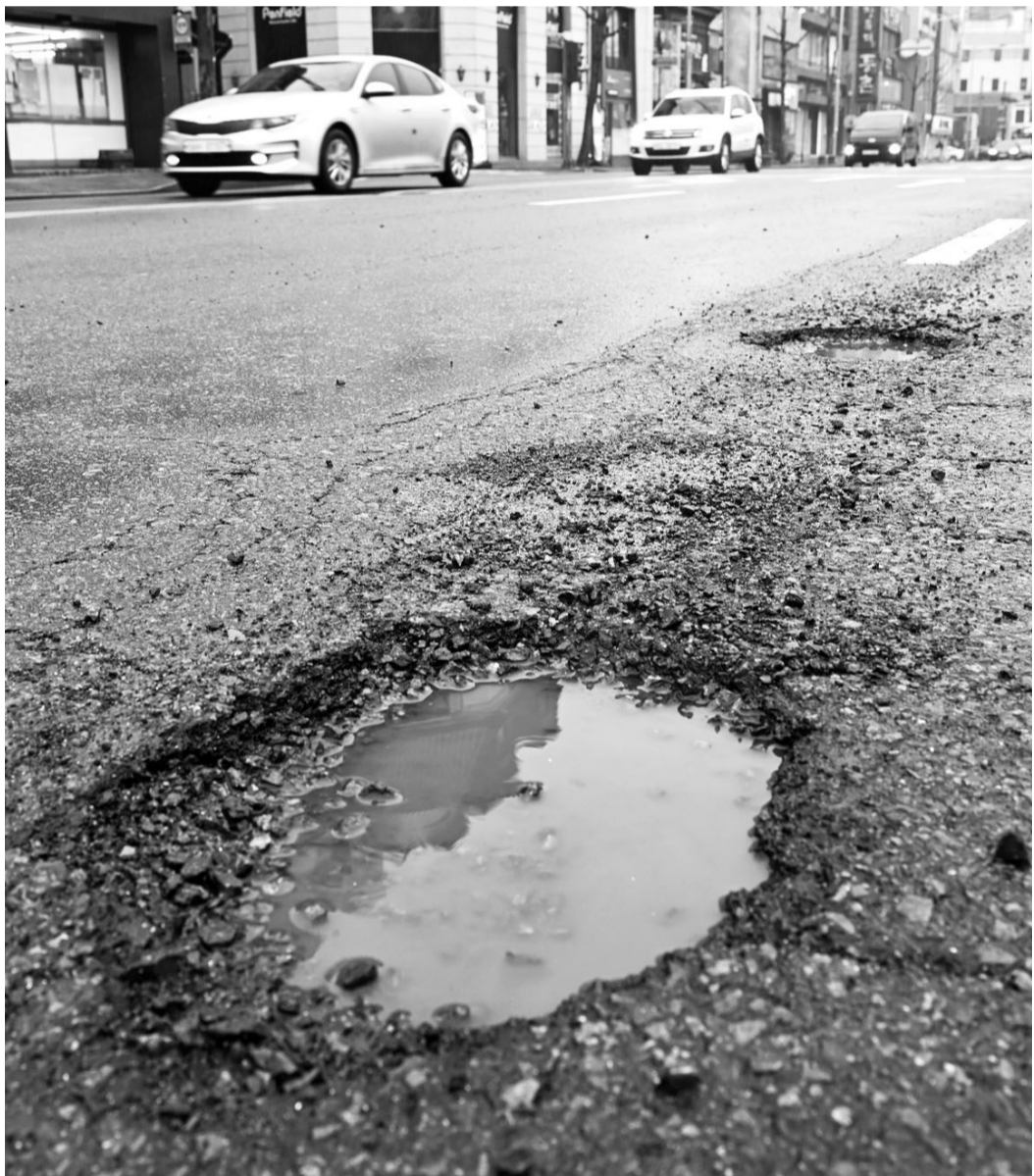
금남로 곳곳 위험천만 포트홀 13일 광주 동구 금남로 아스팔트 도로 곳곳에 생긴 포트홀에 물이 고여 있다. /김진수 기자 jeans@kwangju.co.kr
