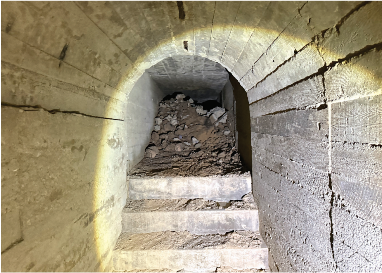
광주시 서구 쌍촌동 5·18 역사공원 제1주차장에서 발견된 지하벙커 통로 일부가 쓸려내려온 토사에 의해 막혀있다.
