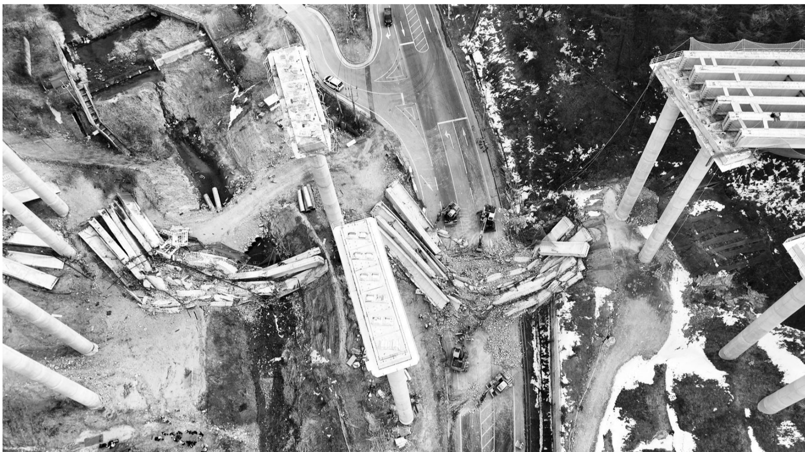
25일 경기도 안성시 서운면 산평리 소재 서울세종고속도로 천안~안성구간 9공구 천용천교 건설 현장에서 교량 연결작업 중 교각에 올려놓았던 상판이 무너지는 사고가 발생해 작업자 4명이 숨지고 6명이 다쳤다. /연합뉴스
