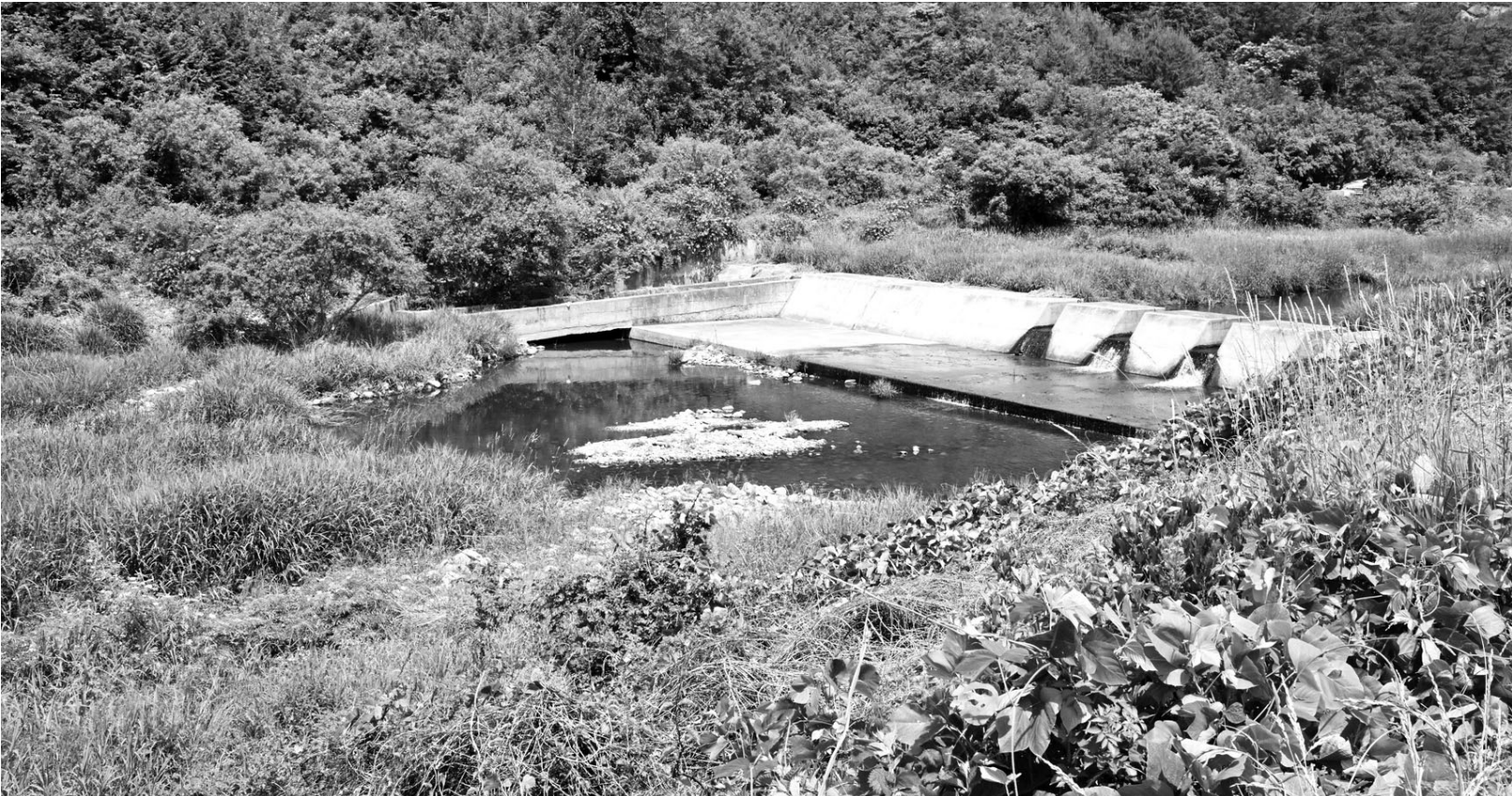
장흥군 유치면 관동리 하천에 설치된 보에 어도가 설치돼있다. 해당 어도인 '관동리1 어도1'은 내부에 물이 흐르지 않고 침식 및 퇴적이 심해 개보수대상인 '불량' 판정을 받았다.
