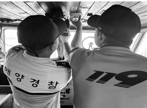
완도항 내 장기계류선박 15척에 ‘단독 경보형 화재감지기’를 설치하는 완도해경과 완도소방.
